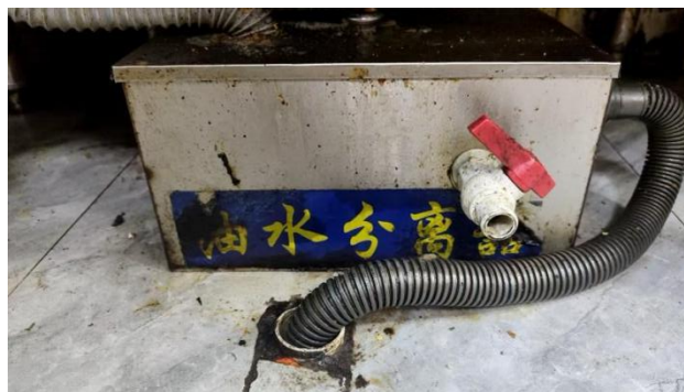
图 2-7 现有项目食堂油水分离器
