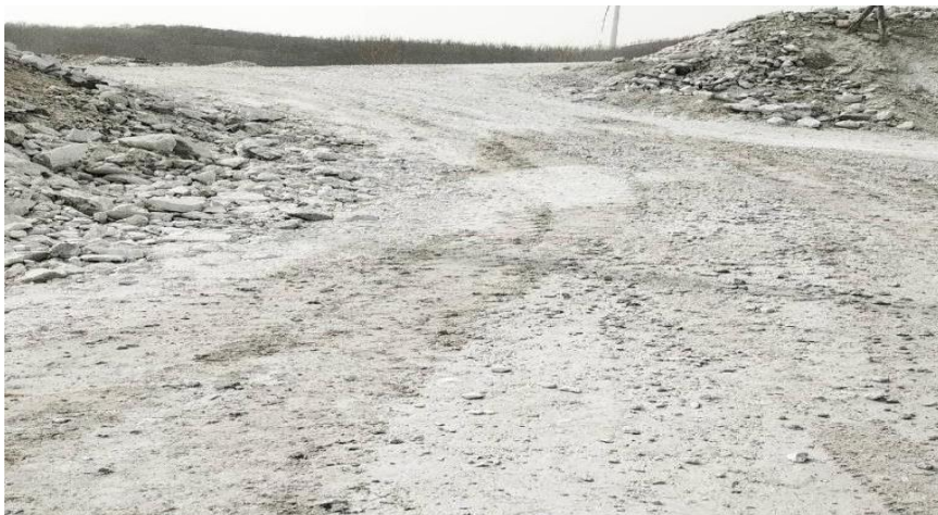
图 3-8 道路损毁土地现状
